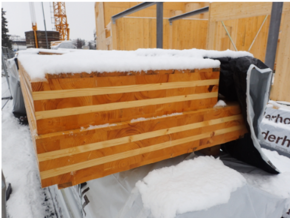
Figur 1: Eksempel på feil midlertidig lagring av massivtreelementer på byggeplass, som fører til unødvendig mye byggfukt som må tørke ut. (Foto: Tore Kvande, NTNU)
