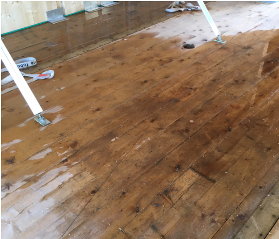
Figur 4: Dersom massivtreet har blitt utsatt for nedbør er det viktig med rask fjerning av overflatevann, for å unngå at vannet trekker inn i trevirket. Videre bør man sørge for at massivtreet tørker godt ut før innbygging, siden kompakte massivtreetak har lav uttørkingsevne.
