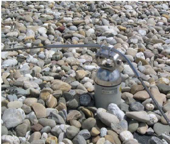
Figur 4.3. Eksempel på festepunkt for sikkerhetsline. Sikkerhetsselen hektes på wiren med en spesiell låsemekanisme og som kan gli langs wiren.
