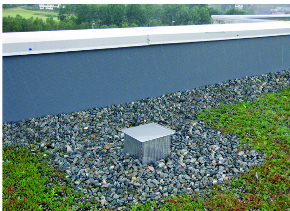
Figur 3.5 Eksempel på inspeksjonsbrønn for sluk i sedumtak der det også er utskiftet med ubrennbare materialer rundt sluk og nedløpsrør.
